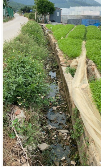
图40 排水渠杂草丛生实地照片
