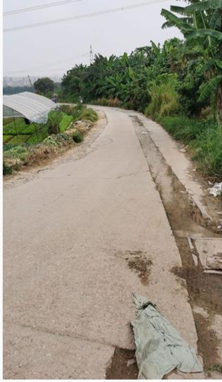
图39 损毁田间道路现状照片
