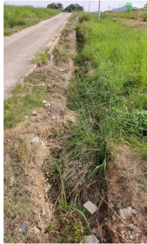
图24 已堵塞的沟渠
