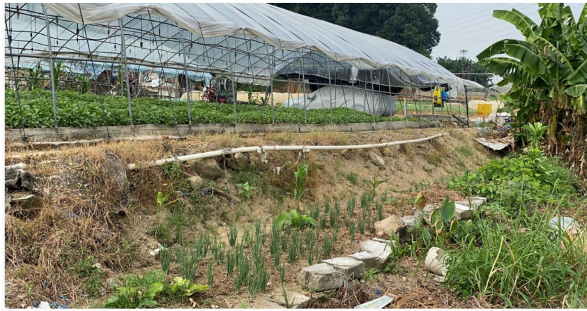
图41 护坡损毁严重实地照片
