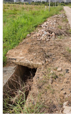
图25 下田坡道已损毁
