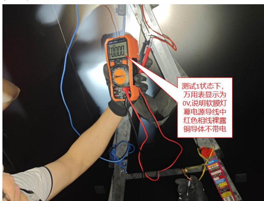
图 28 测试 1 状态下软膜灯幕电源导线中的红色相线裸露铜导体带电情况测试
