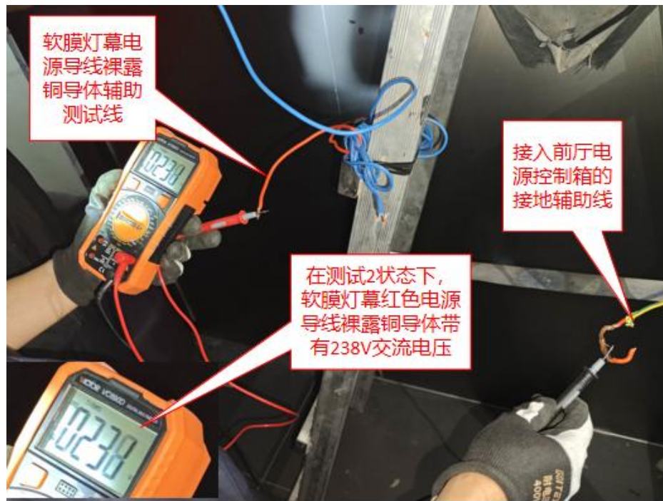
图 29 测试 2 状态下软膜灯幕电源导线中的红色相线裸露铜导体带电情况测试
