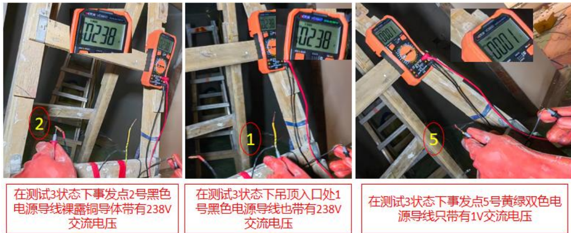
图 25 测试 3 状态下 1 号和 2 号黑色电源导线 5 号黄绿双色电源导线带电情况测试
