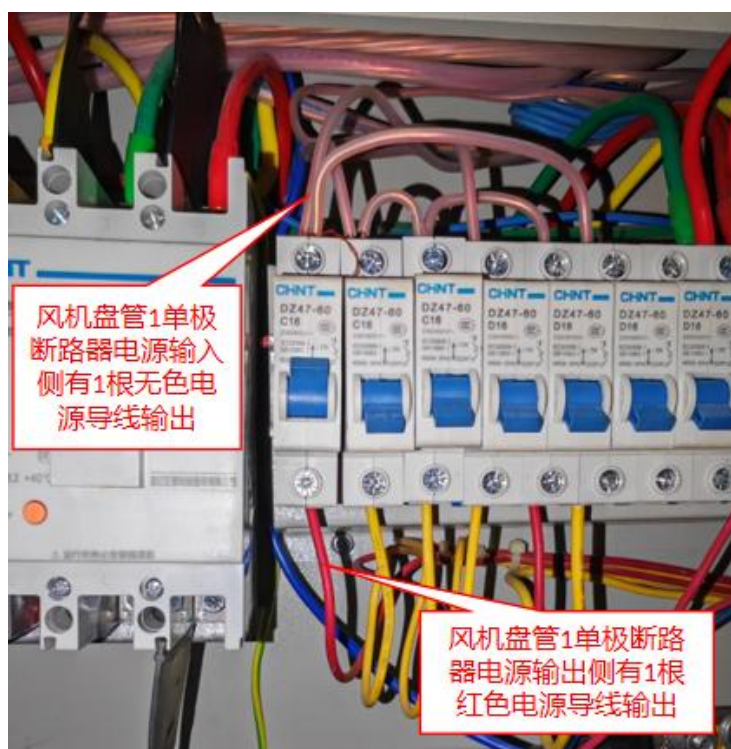
图 18 6 层配电室 16ZAL1 配电箱现场勘查图（三）
