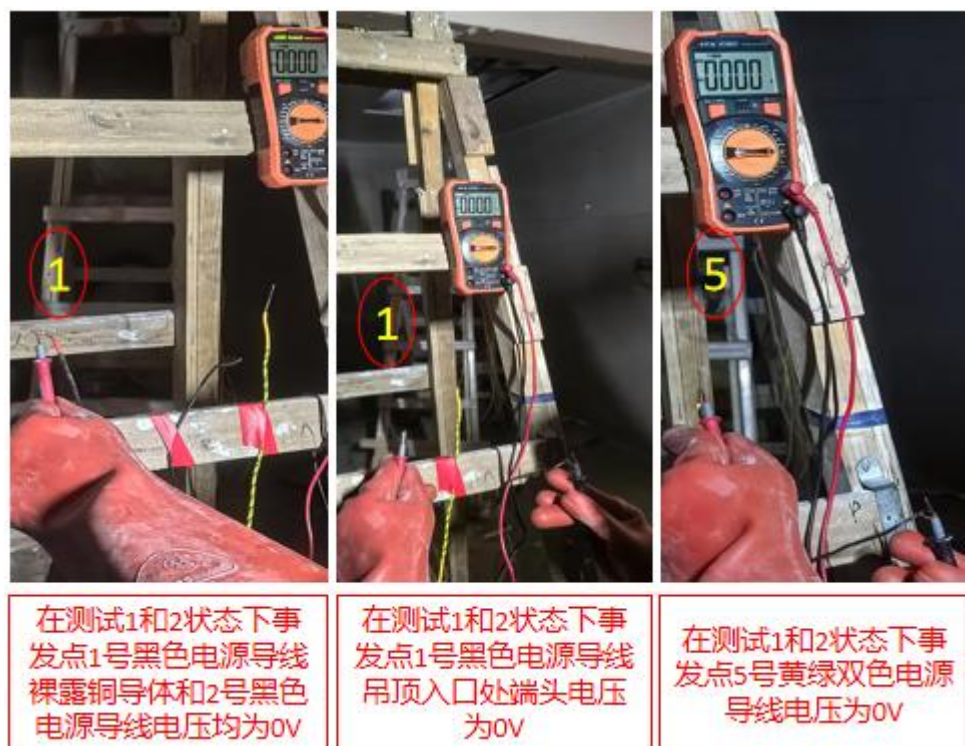
图 24 测试 1 和测试 2 状态下 1 号和 2 号黑色电源导线 5 号黄绿双色电源导线带电情况测试
