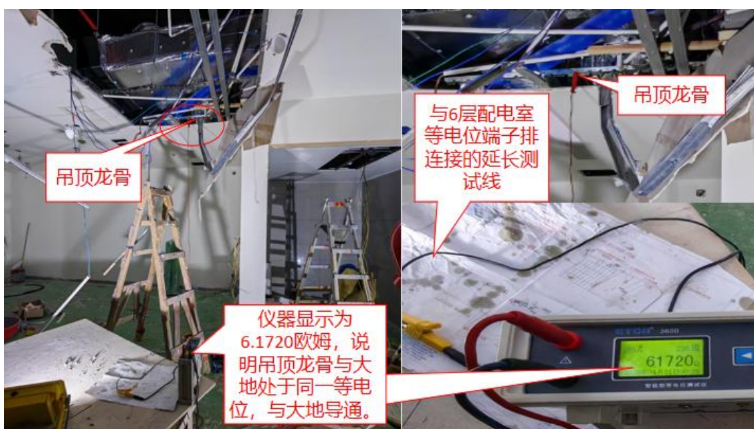
图 22 吊顶金属龙骨与 6 层配电室等电位端子排 PE 极等电位测试
