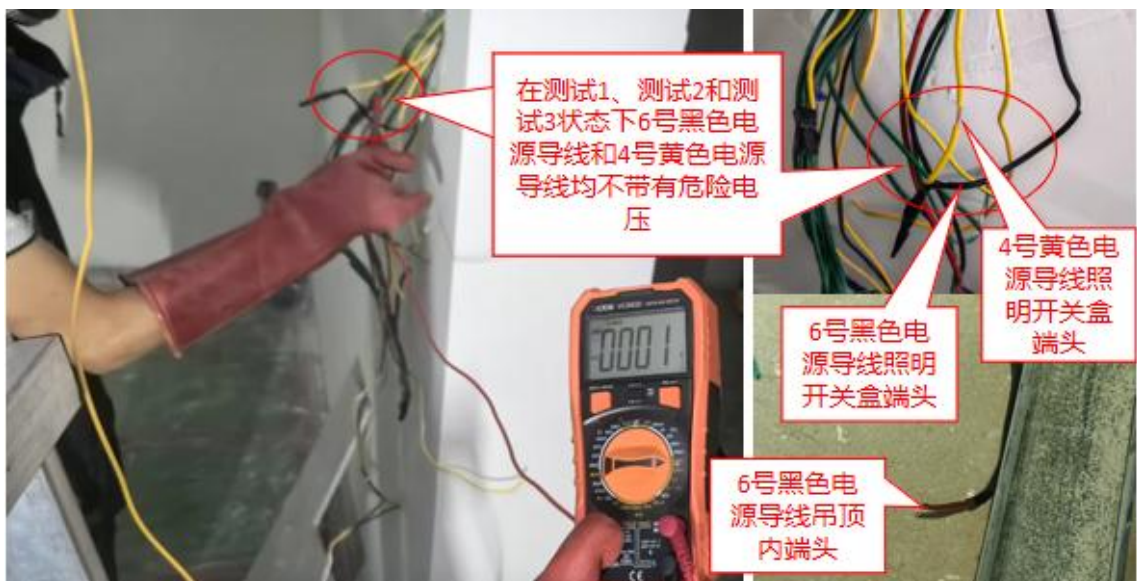
图 26 在测试 1、测试 2、测试 3 状态下，4 号黄色电源导线、 6 号黑色电源导线带电情况测试
