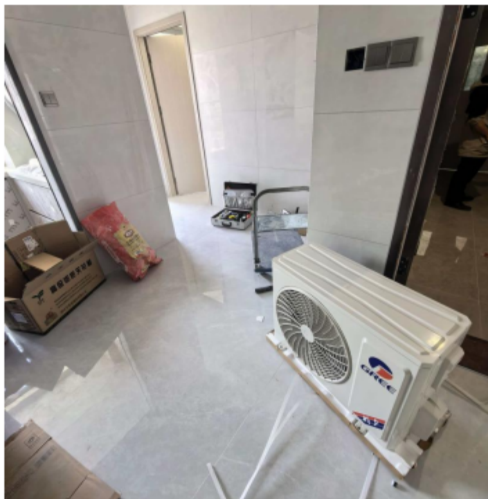
图 4 未完成安装的空调外机
