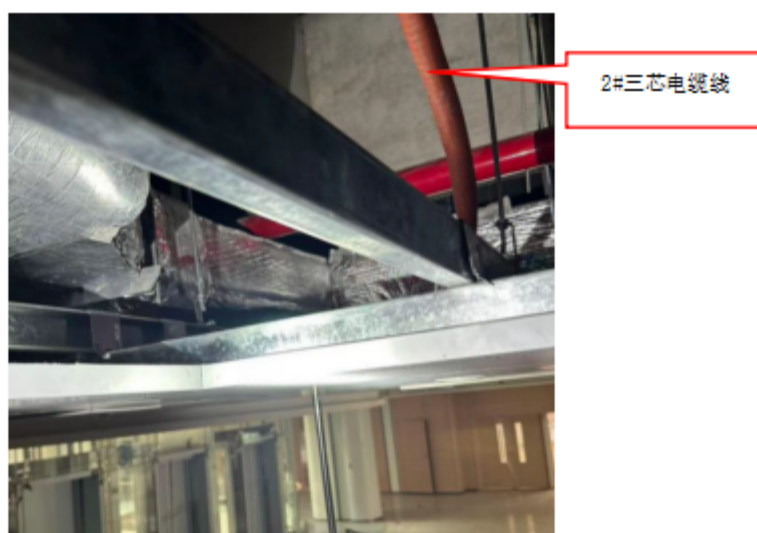
图 6 电缆线（2#三芯电缆线）接线勘查图
