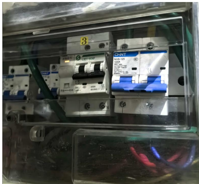
图6 公寓外墙总空气开关和自动断路器
