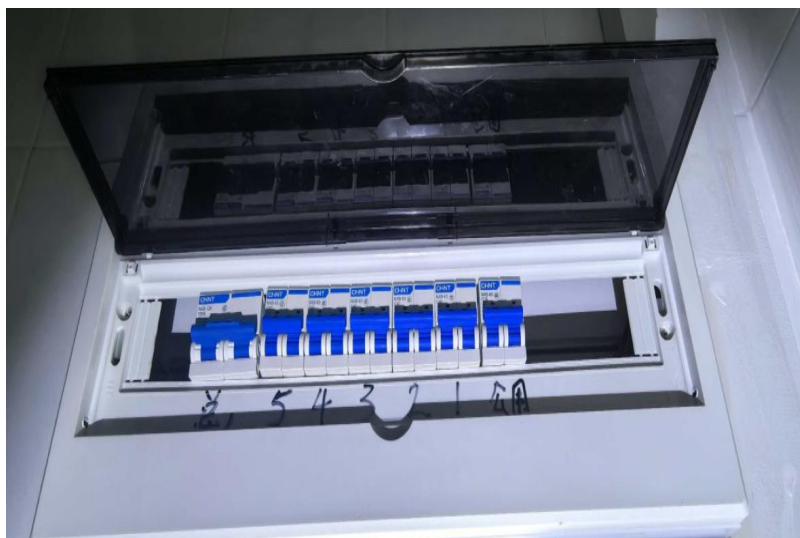
图 7 二楼楼梯间开关箱
