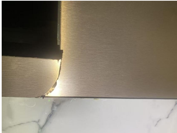
图5 检修口下方破损痕迹
