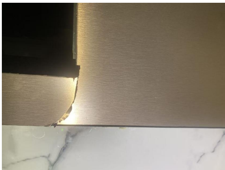
图 5 检修口下方破损痕迹
