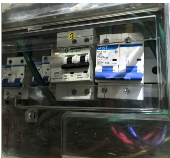
图 6 公寓外墙总空气开关和自动断路器
