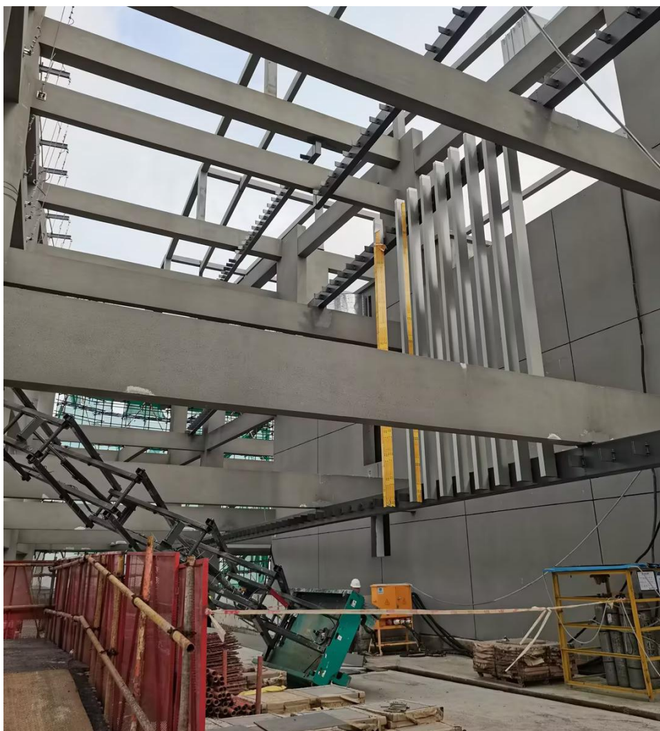
图 4 事故现场安装格栅情况图
