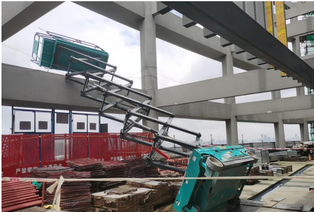
图 3 事故现场剪叉式升降车倾倒情况图
